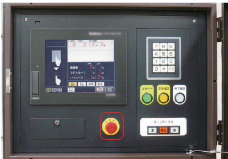
緊急停止ボタンの設置例
